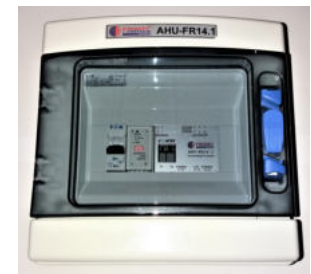
Komunikační box AHU-FR19.1
