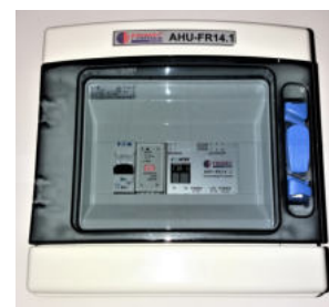
Komunikační box AHU-FR14.1
